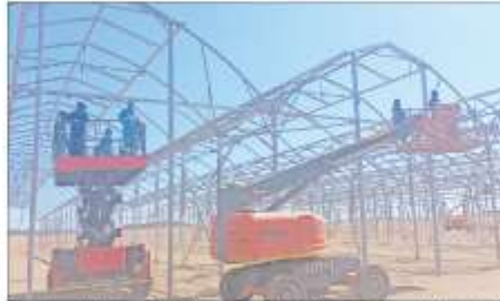
Groot kweekhuise met drupbesproeiingsstelsels word gebou vir topgehalte landbouproduksie. FOTO ANGETTO GRAIG
